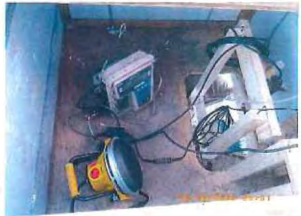
Équipements installés à l'intérieur
