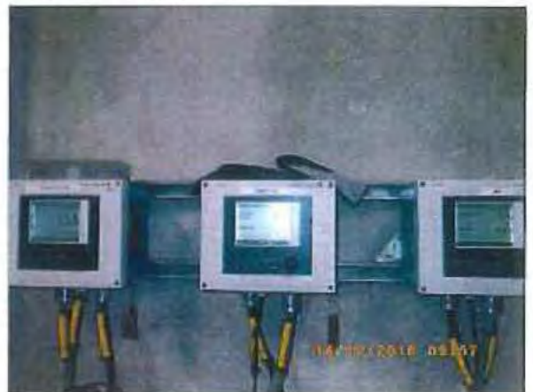
Station de contrôle de l'effluent final – équipements de mesure
